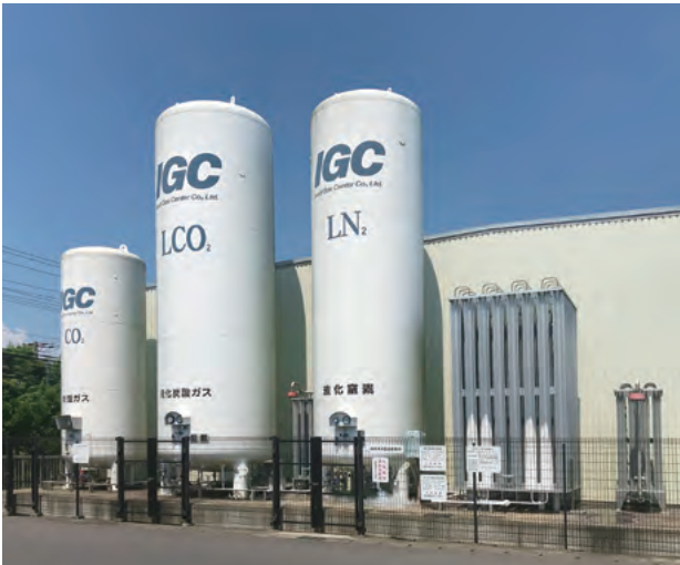
ハロン1301精製用液化窒素タンク
