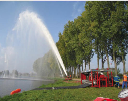
大型のFireDos混合システムと放水砲を組み合わせれば、大容量泡放射システムとして運用することもできる。（写真提供/日本ドライケミカル）
