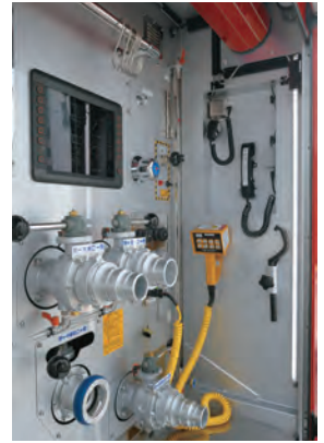
▼ポンプ操作室内には通信装置、キャブや車両の周囲にいる隊員との連絡用の拡声装置を設置し、照明装置のリモコンも収納。通信装置はシャッタースイッチと連動し、救急無線などの拡声の切断が容易。
