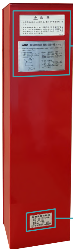
起動操作格納箱
