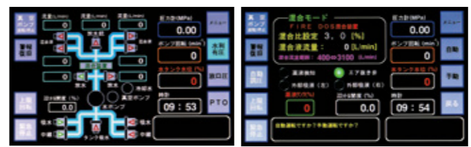
ポンプ操作盤のモニター。アンサーバックも採用されているわかりやすいタッチパネル式で、経験の浅い隊員でも間違いのない操作が可能。混合比率は3%固定で、泡消火薬剤はクラスBを用いる。
